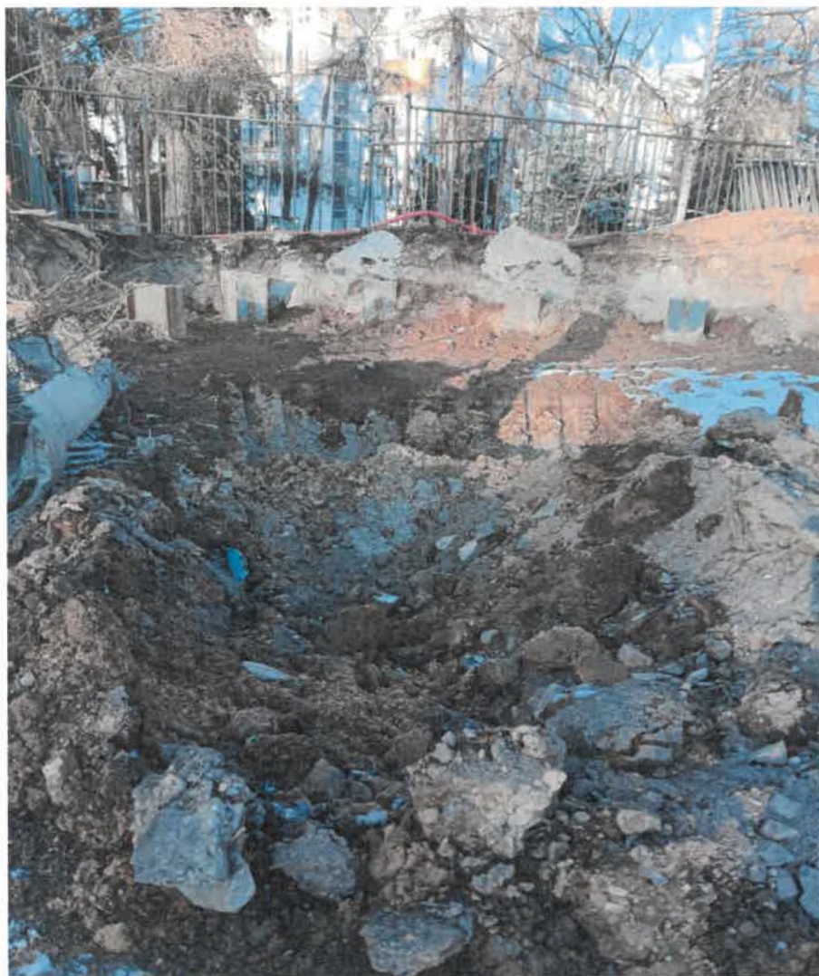
Fotografie č. 1 - kontaminovaná zemina směsným odpadem v prostoru výkopu objektu SO 05 - retenční nádrž
