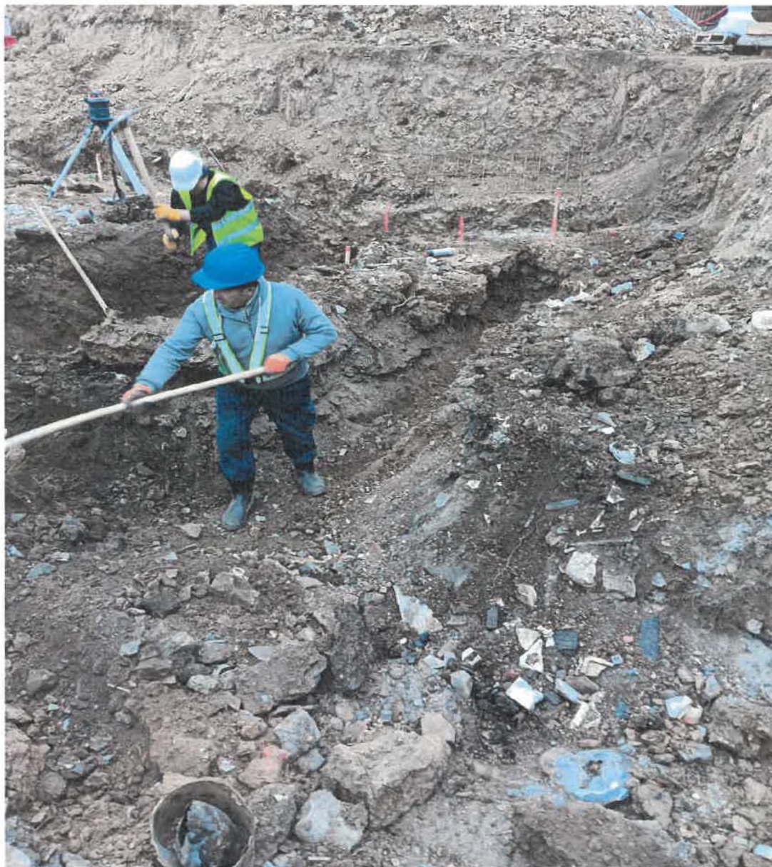
Fotografie č. 2 - kontaminovaná zemina směsným odpadem v prostoru výkopu objektu SO 01
